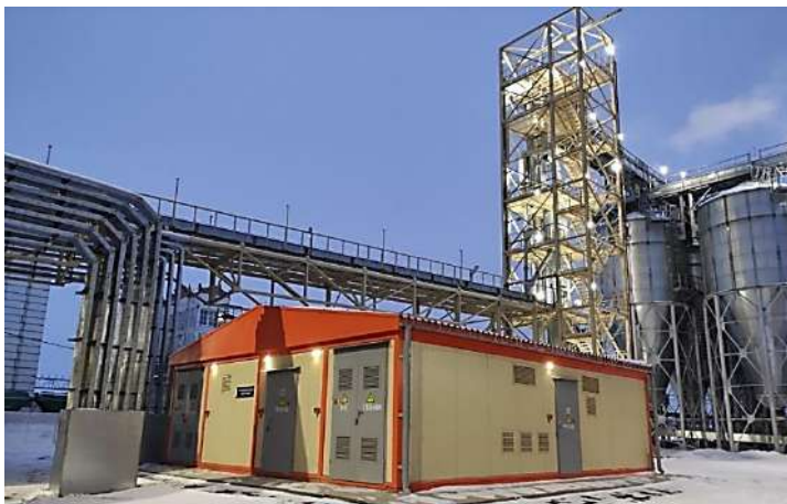
Рис. 1. Общий вид цифровой подстанции нового поколения
