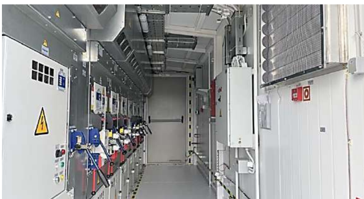
Рис. 1. Общий вид блочных комплектных универсальных РУ на базе КСО-298
