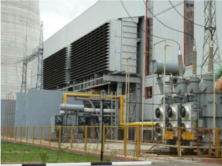
Рис. 2. Вращающаяся сторона КВОУ. Объект ТЭЦ-21 (Мосэнерго)
