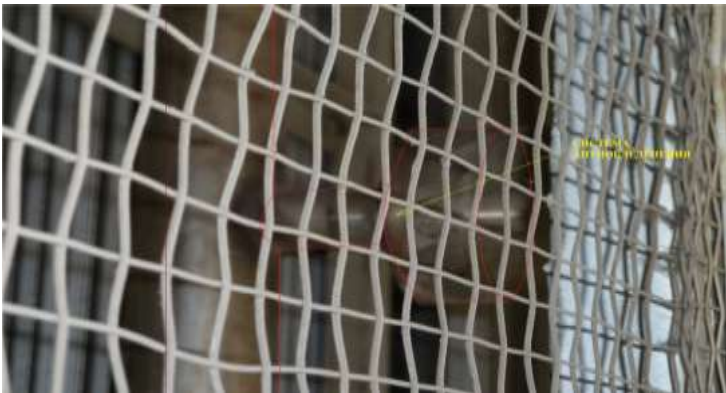
Рис. 3. Элемент обогрева САО КВОУ. Объект ТЭЦ-21 (Мосэнерго)
