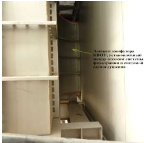
Рис. 4. Конфузор КВОУ. Объект ТЭЦ-21 (Мосэнерго)
